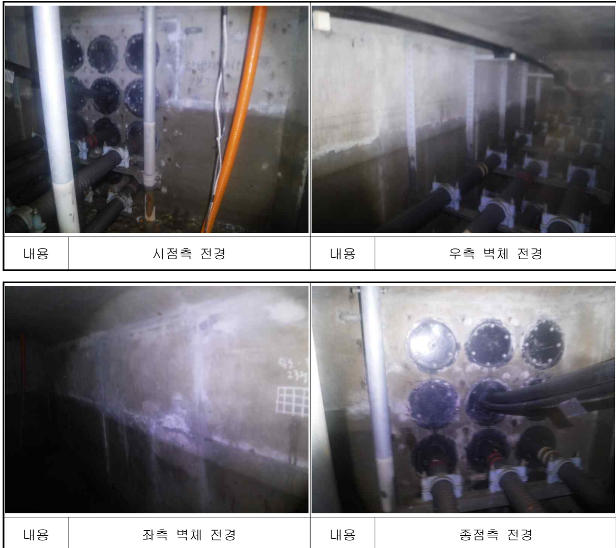
[사진 3.1] 덕소~진건#S/S 전경
