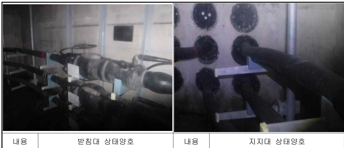
【사진 3.12】 부속 및 부대설비 현황
