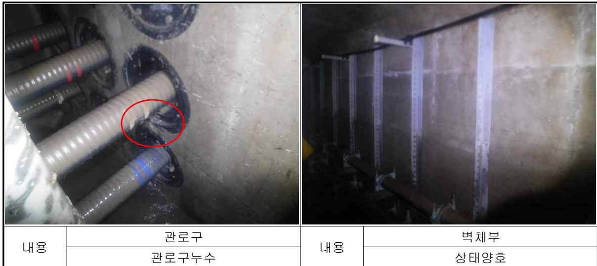
【사진 3.6】 맨홀 내부 주요 손상
