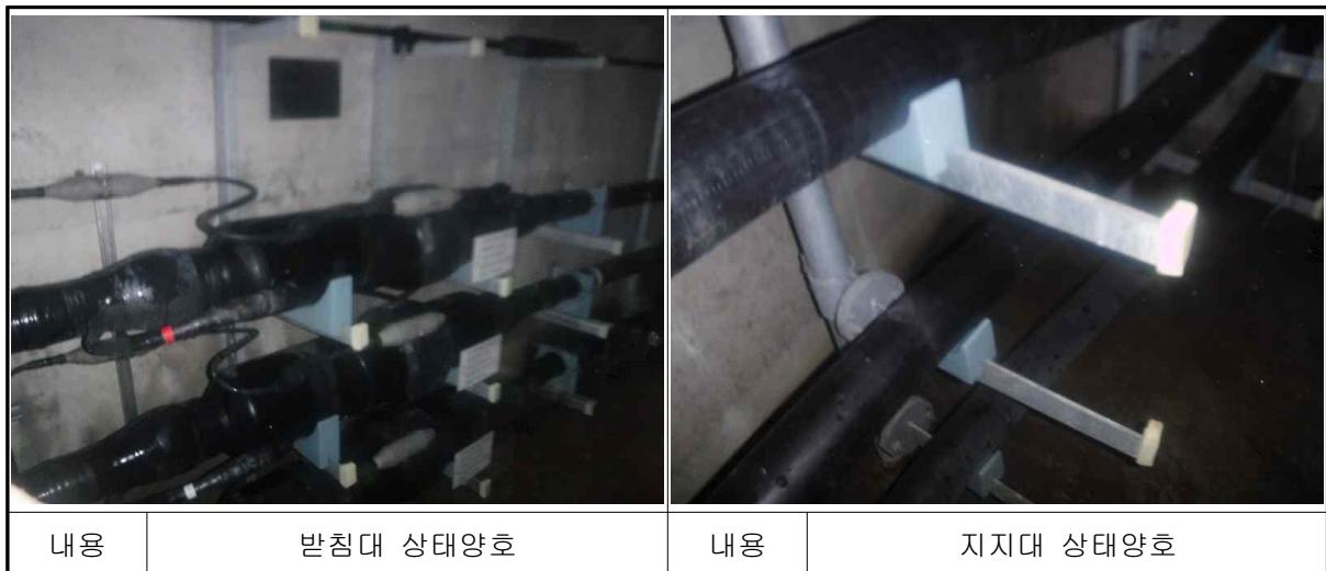
【사진 3.16】 부속 및 부대설비 현황
