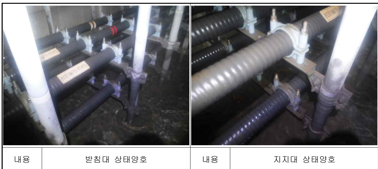
【사진 3.4】 부속 및 부대설비 현황
